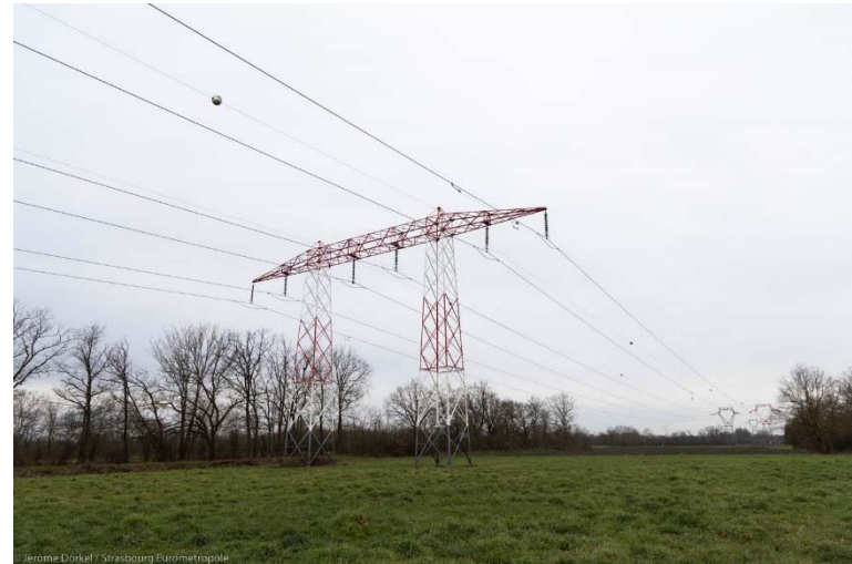
Pilône électrique pour ligne à haute tension à Eckbolsheim
